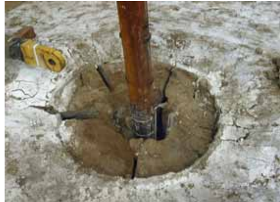
図-2.4.16 試験終了後の杭頭状況
