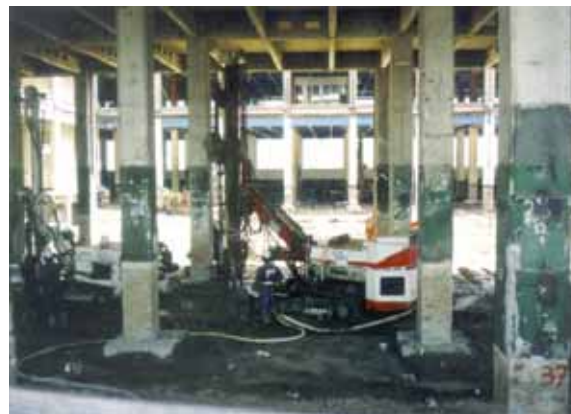
図-1.1.2 海外でのマイクロパイル施工事例 (既設構造物のアンダーピニング)
