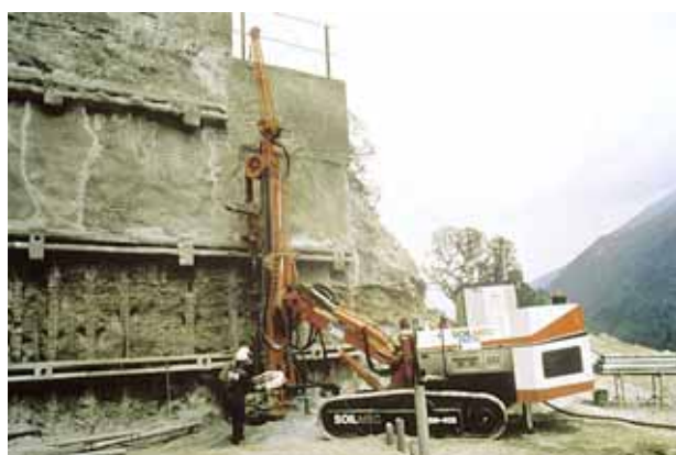
図-1.1.1 海外でのマイクロパイル施工事例 (山岳トンネル坑口部などの擁壁工)
