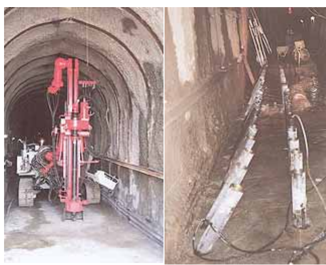
図-1.1.4 国内でのマイクロパイル施工事例 (山岳トンネルの脚部補強 1) )
