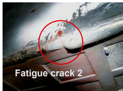
写真-8 疲労亀裂発生状況(亀裂 2 拡大)
