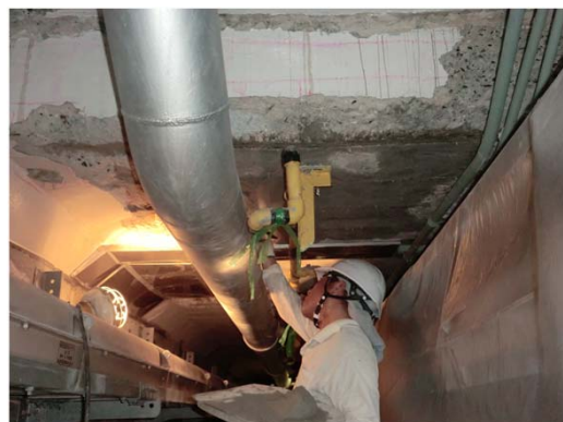
写真 火力発電所(ケーブル洞道)コンクリート塩害劣化補修
