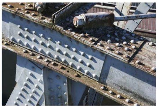
トラス上部 腐食状況
