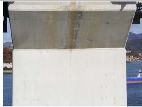
橋脚上部 腐食状況
