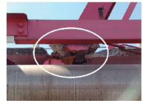
木曾川トラス橋 斜材破断事故
