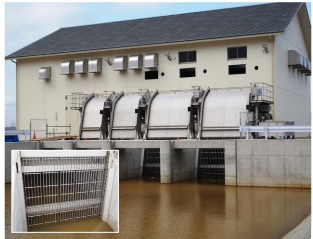
図5. 実績例: 排水機場除塵設備
