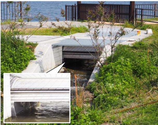
図4. 実績例: 遠賀川魚道ゲート
