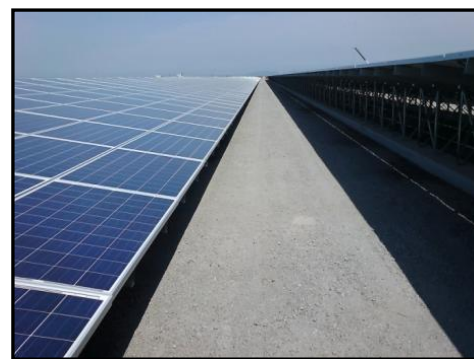
太陽光発電敷地
