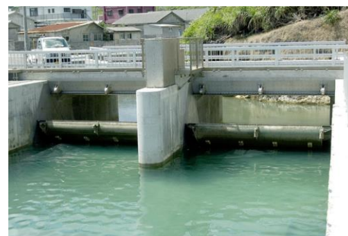
施工例:(防潮水門ゲート設備)
