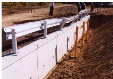
Gr・L型擁壁H1500 衝突後の状況
