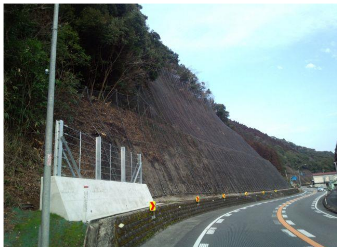
落石防護網(ロックネット)
