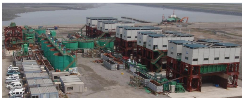
「浚渫底泥高圧脱水処理システム」を採用している 新門司沖土砂処分場の築堤材製作工事
