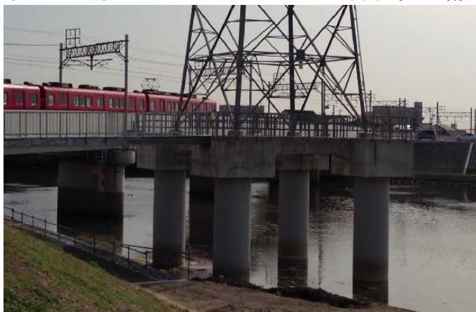
3) 河川内の鋼管基礎の防錆事例 流木等にも傷が付きにくい(2mm仕様)
