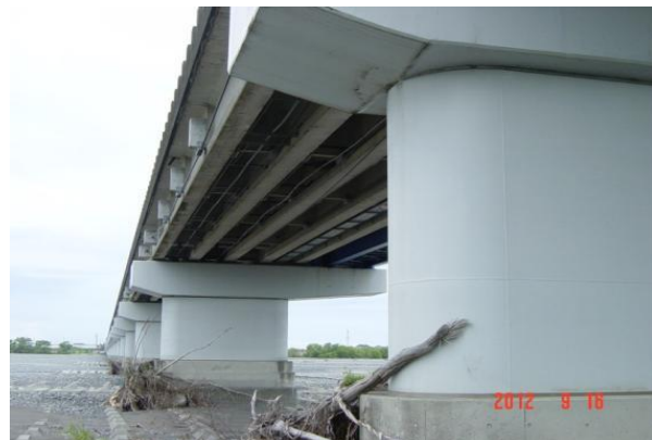
2) 鋼板巻立補強した橋脚に防錆塗装した事例 流木等にも傷が付きにくい(2mm仕様)
