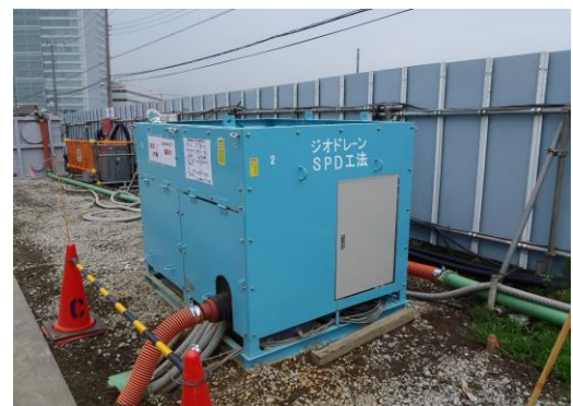
写真-2 真空装置
