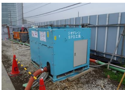
写真-1.1 真空装置
