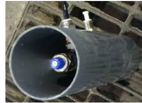
写真-1 注水状況
