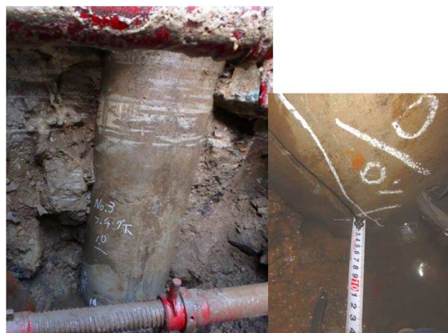
写真-2 掘削目視基礎杭被害状況
