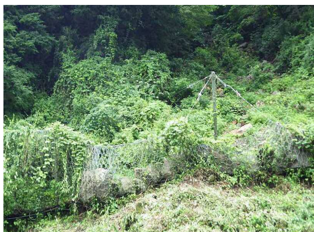
熊本地震落石捕捉実績
