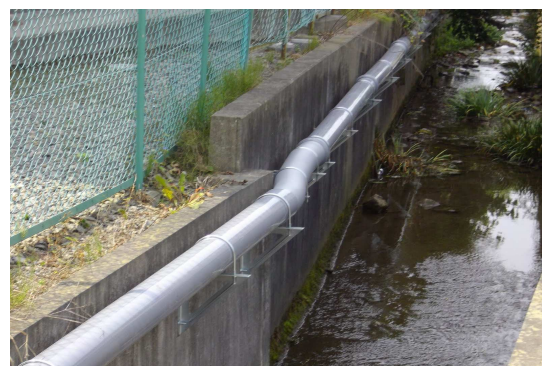
仮設排水配管
