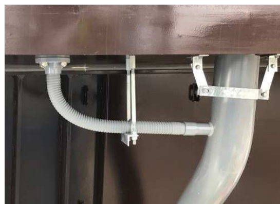
橋梁用床版水抜きパイプとの組み合わせ 融雪剤によるステンフレキの
