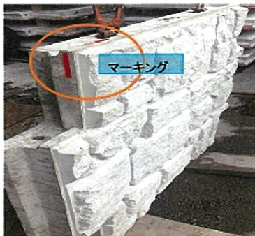
c) 変状サイン(マーキング)
