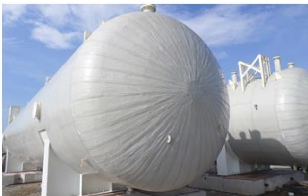
図5 事例: タンクの腐食対策
