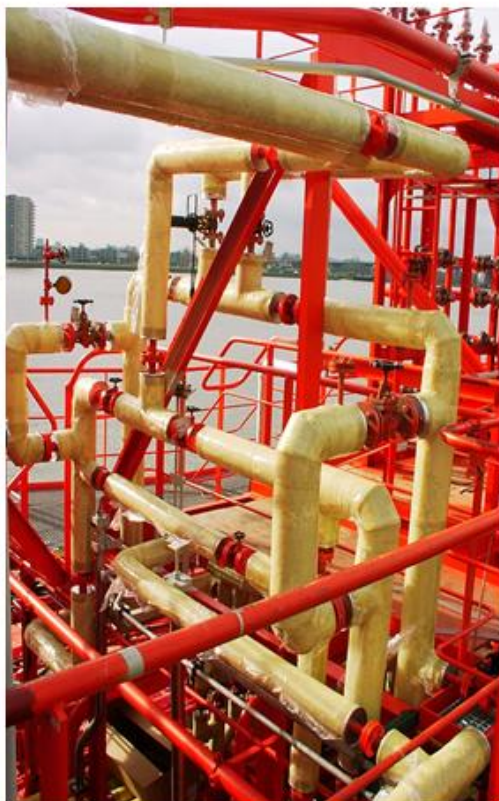
図3 事例: 配管の腐食対策
