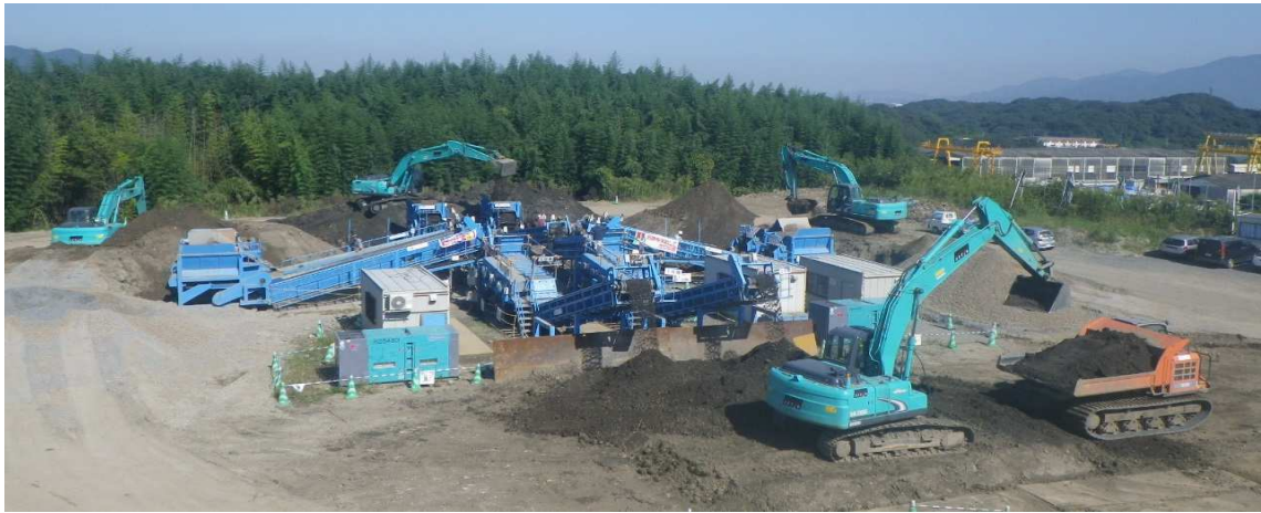
万能土質改良システムの全景
