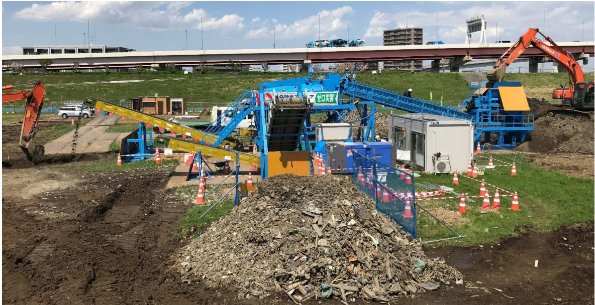
土砂分別システム 全景
