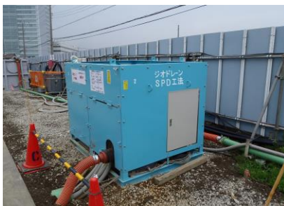
写真-1.1 真空装置
