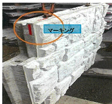
c) 変状サイン(マーキング)
