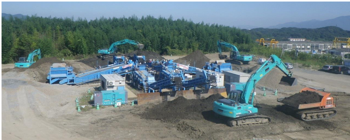
万能土質改良システムの全景
