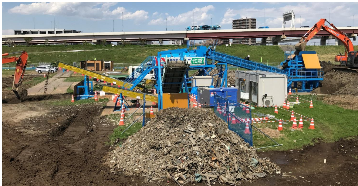
土砂分別システム 全景
