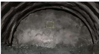
マーキングによる不安定部の明示
