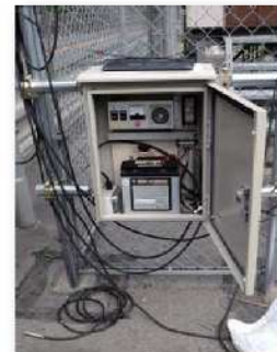
バッテリー内部の状況
