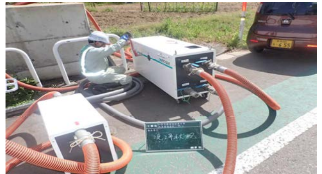
図3: 気水洗浄装置作動状況
