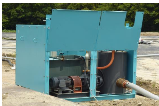
写真-2 真空装置
