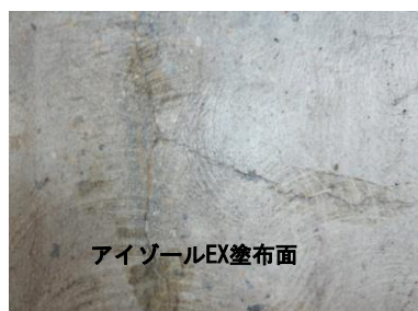
③塗布後もひび割れを可視化
