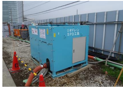
写真-1.1 真空装置
