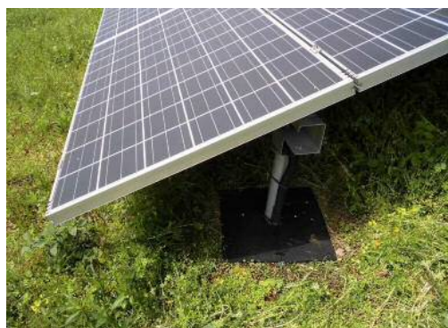
太陽光発電所
