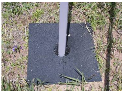
太陽光発電所
