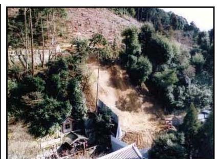
平成 11 年の斜面崩壊
